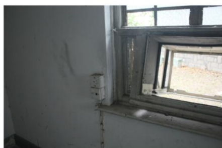
冷氣機位有鬆脫情況
