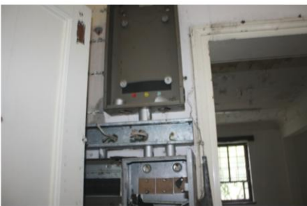
供電設施殘舊
