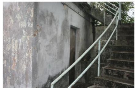
抹灰外牆褪色
